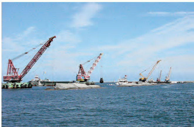
八太郎地区の北防波堤中央部での復旧工事 提供：八戸港湾・空港整備事務所
